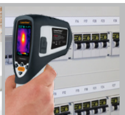
Análise de fusíveis sobrecarregados
